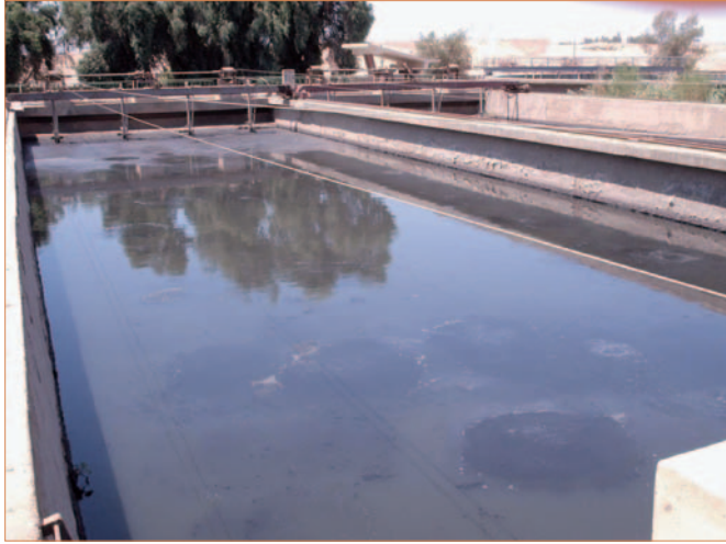
بركة الأكسدة في مشروع الصرف الصحي - كوم الضبع
