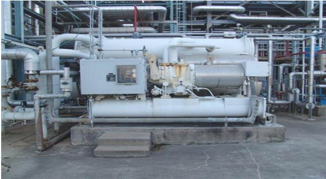
صورة (٣-٣) وحدة تبريد مركزية تعمل بغاز R-١٢ المستنفدة لطبقة الأوزون
