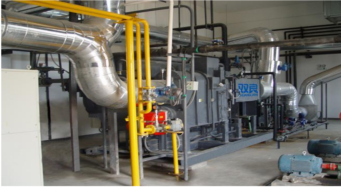
صورة (٣-٤) وحدة تبريد مركزية صديقة للبيئة تعمل بطريقة الإمتصاص
