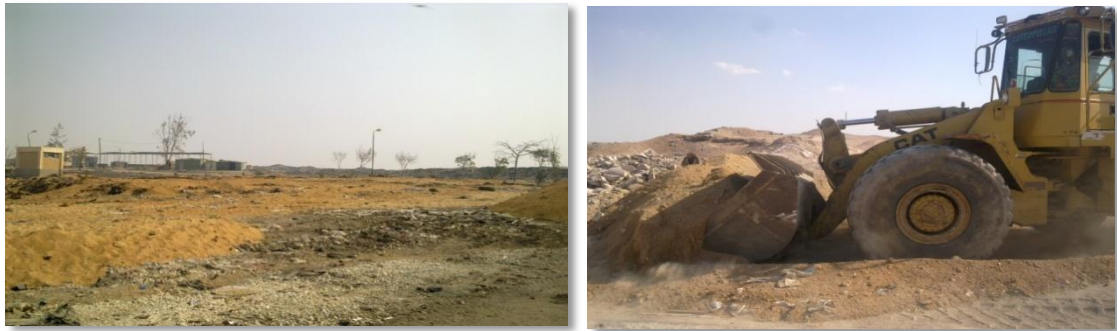
صورة (١٢-٢) مقلب شبرامنت أثناء أعمال السيطرة
